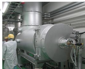
焼却処理設備
